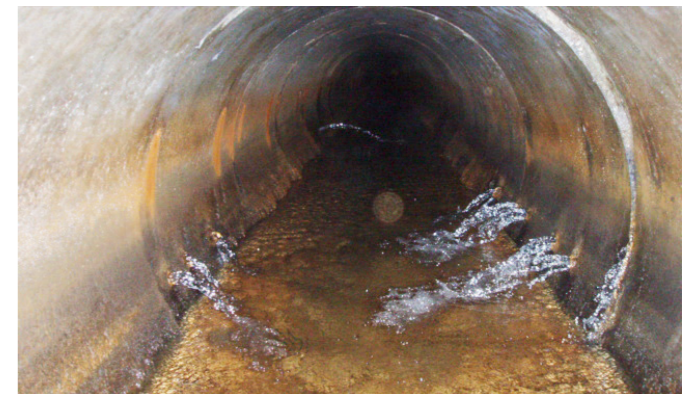
Sickerkanal mit Sickerwasserzutritt
