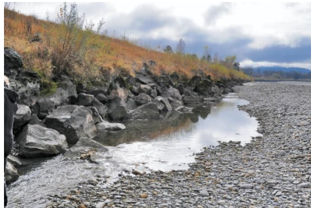
Vertiefung/Kolk am Dammfuss, Alpenrhein.
