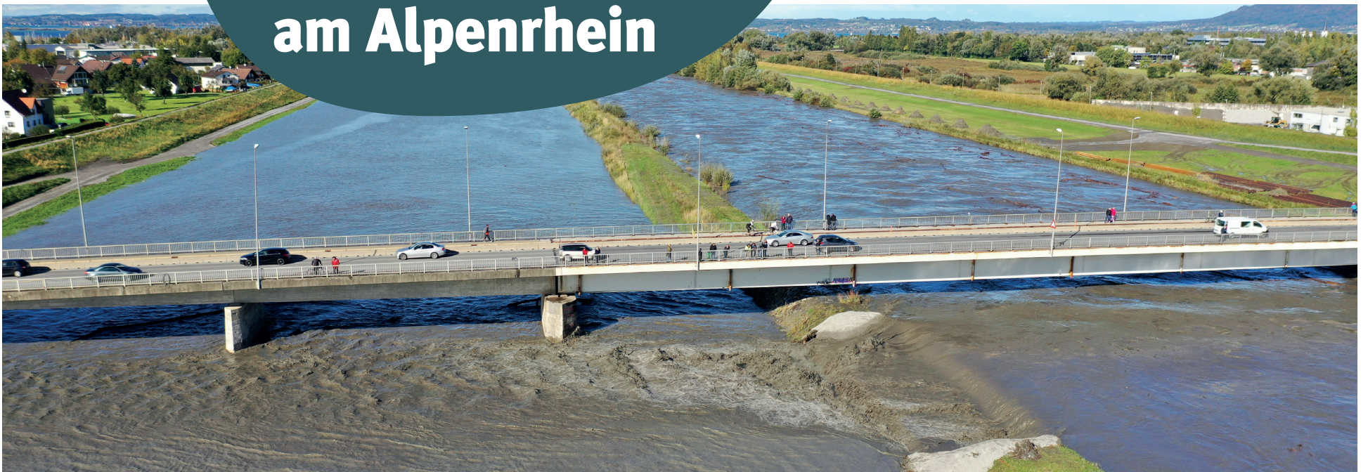
Oktober 2020: Überströmung der Mittelgerinnewuhre bei der Brückenbaustelle Hard-Fussach.
