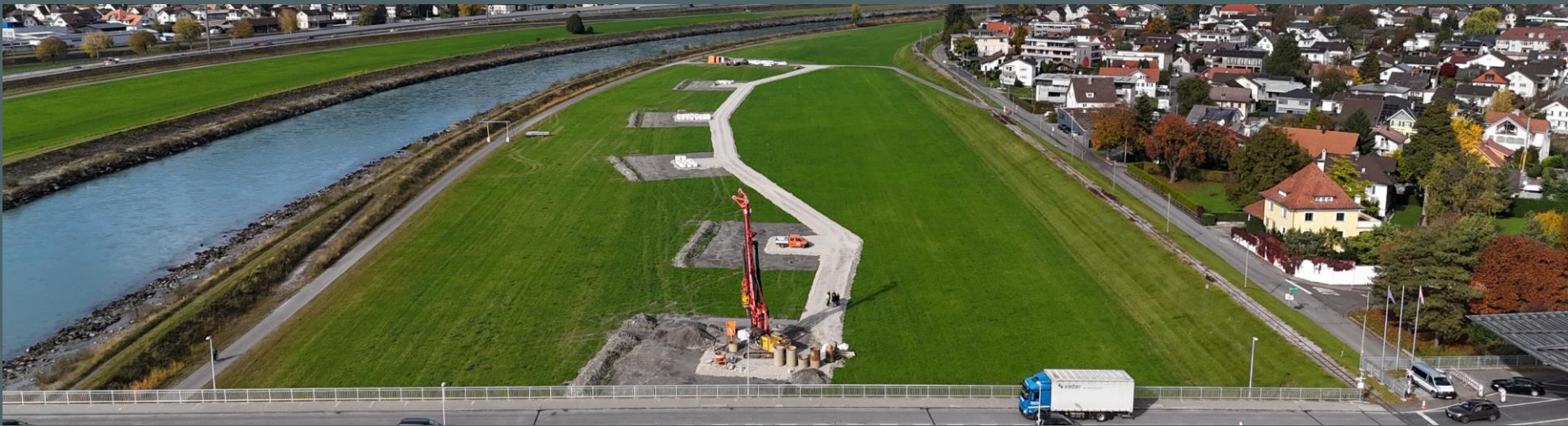
Neue Trinkwasserfassungen Lustenau
